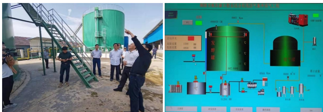
新丰牧业公司畜禽粪污、秸秆沼气发电工程
